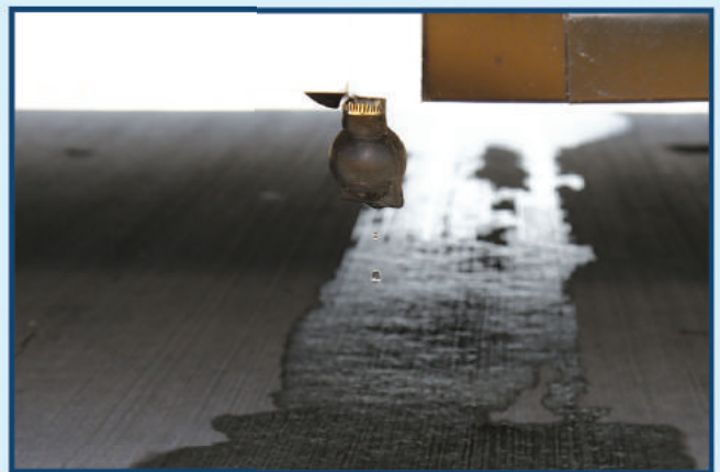
Válvula de desagüe
